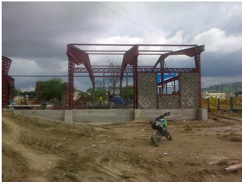
Colocación en la parte lateral de la mampostería en la Biblioteca General.
