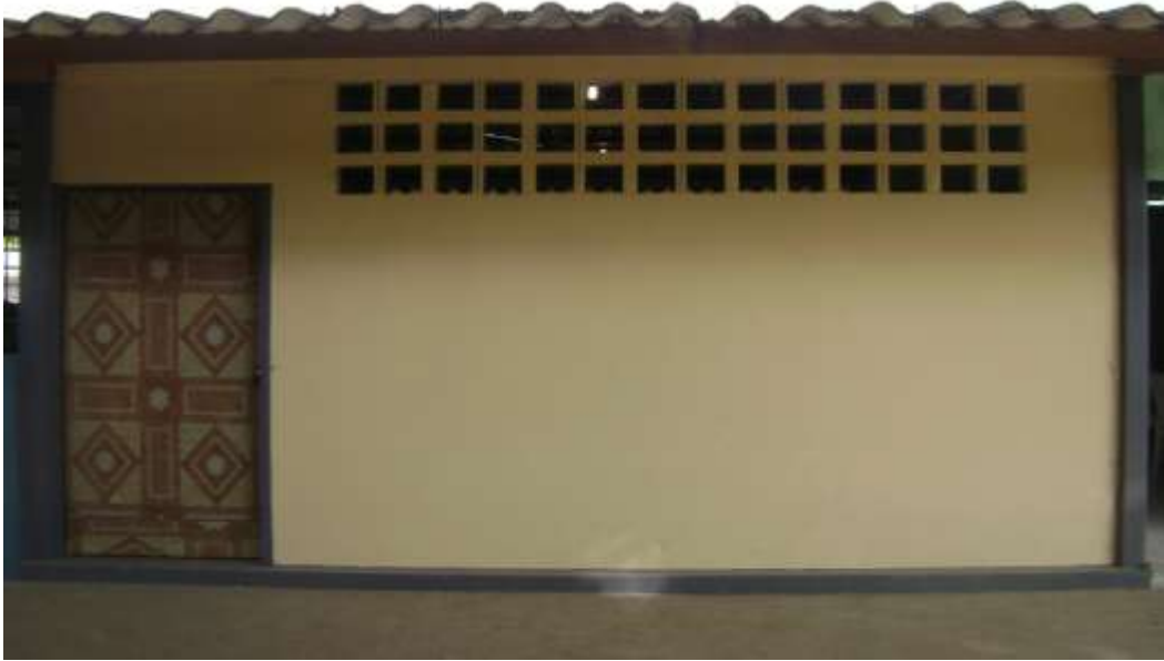
Infraestructura externa del área física ya implementada como Departamento Médico del Colegio 3 de Mayo de Riochico
