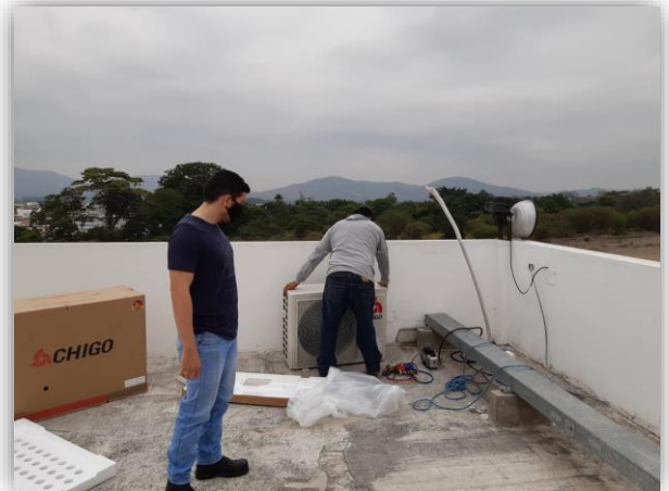
MANTENIMIENTO PREVENTIVO DE LA UNIDAD ETERIOR
