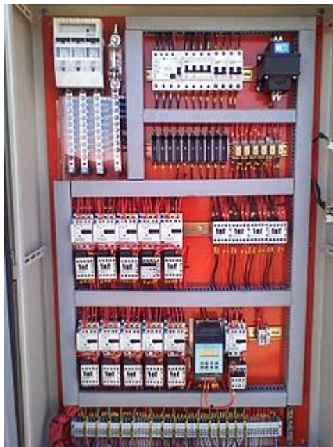
Figura 5. Tablero de distribución eléctrica
