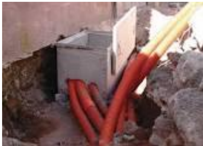
Figura 3. Línea eléctrica soterrada
