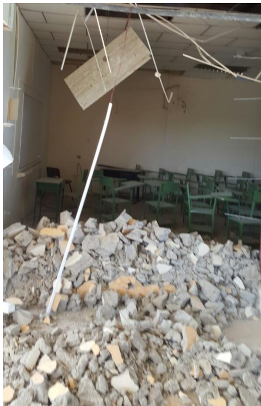
Imagen 12. Mampostería de bloque hueco colapsado en su totalidad.
