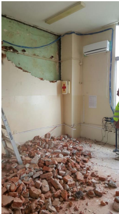
Imagen 10. Mampostería de ladrillo maleta colapsada parcialmente.
