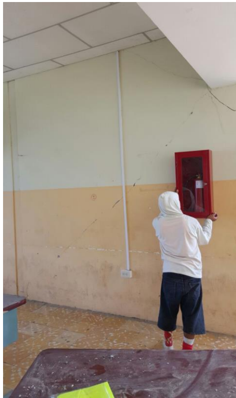
Imagen 11. Mampostería de ladrillo maleta con fisuras diagonales en la superficie de la misma.
