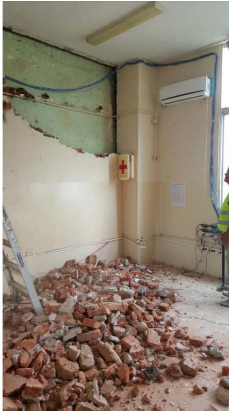
Imagen 16. Mampostería de ladrillo maleta parcialmente colapsado en el Edificio del Instituto de Ciencias Básicas de la Universidad Técnica de Manabí.
