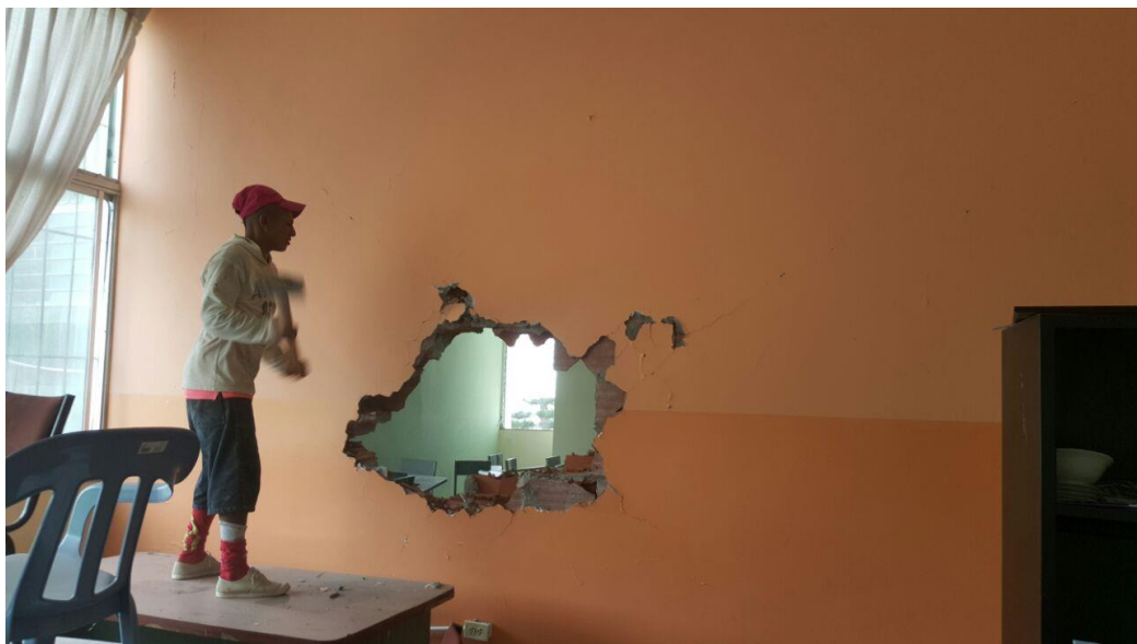
Imagen 17. Derrocamiento de paredes de ladrillo maleta del edificio del Instituto de Ciencias Básicas.
