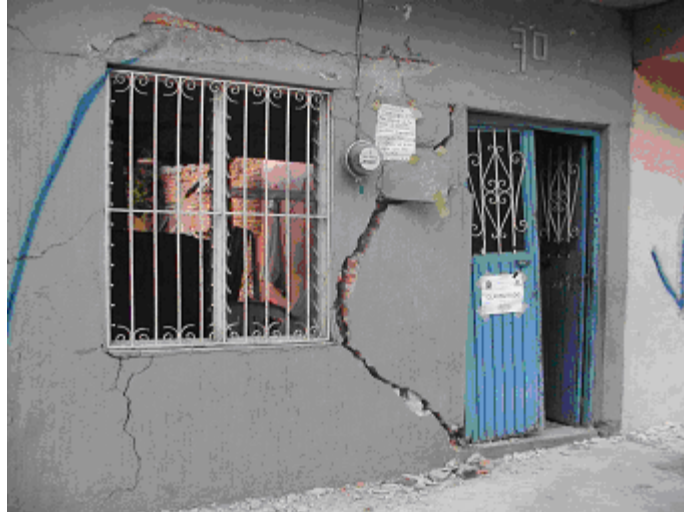
Imagen 7. Grietas en elementos no estructurales, por efectos sísmicos.
