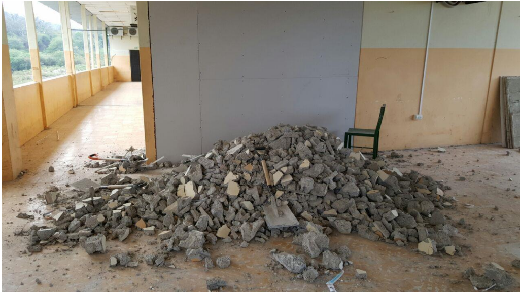
Imagen 9. Paredes de bloque hueco colapsadas en su totalidad.
