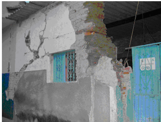
Imagen 6. Paredes parcialmente colapsadas por eventos sísmicos.
