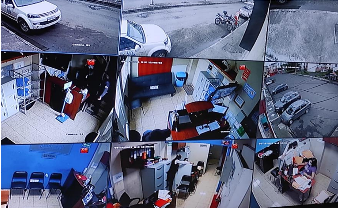
Imagen 15 Cámaras de seguridad
