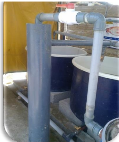
Fotografía 3. Filtro de lechos fluidizados.
