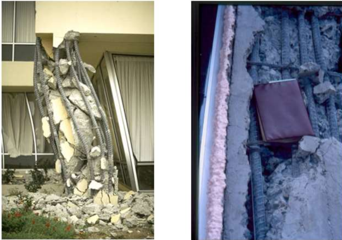
Figura 10 Elementos de hormigón armado que han fallado frágilmente.
