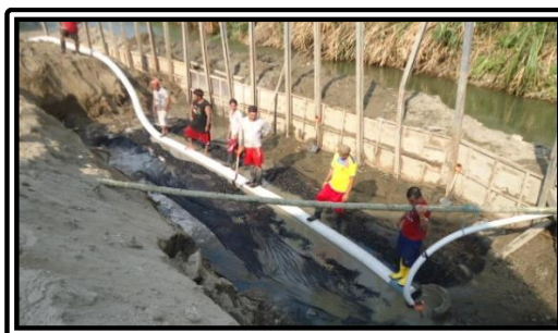
Figura 4. Lámina de polietileno ( E = 0,75 mm), e instalación de tubería PVC ( D = 250 mm)
