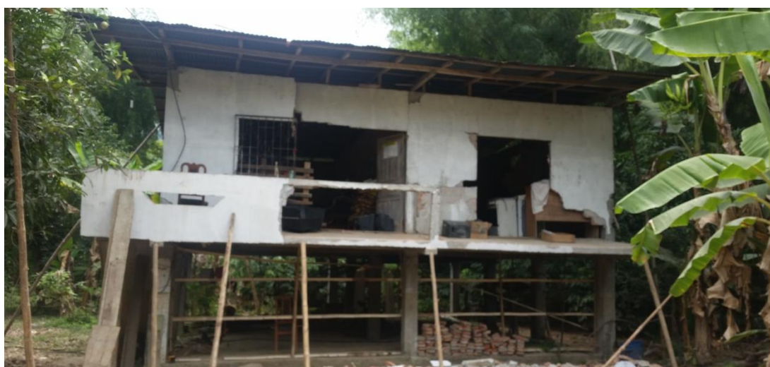
Fig. 13. Vivienda afectada por el terremoto en la parroquia Alajuela.
